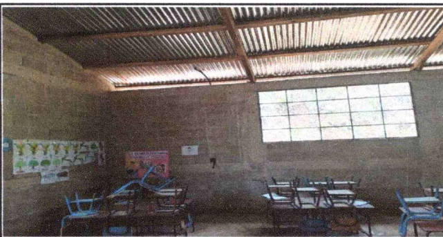
Foto 5: sustitucion de estructura de techo de madera por estructura de techo de metal y cambio de laminas galvanizadas por laminas troqueladas calibre 26
